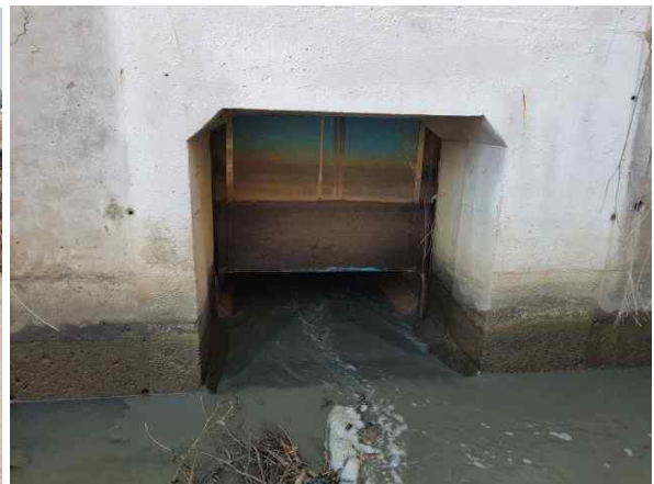
권양기 작동상태 양호
