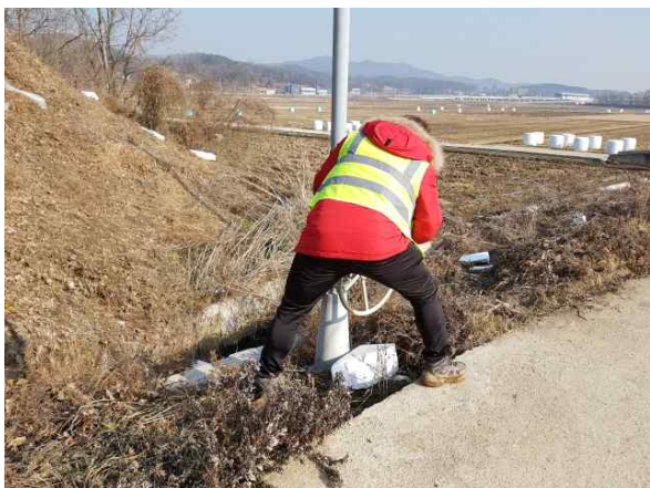
권양기 작동상태 양호
